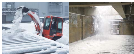
收集雪的地坑 (左: 投入口、右: 地坑内)
