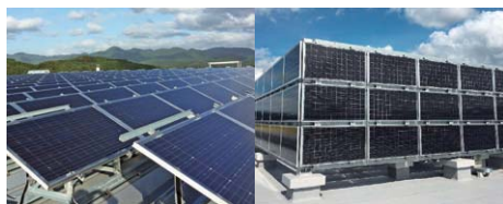
太阳能发电 (不仅安装在屋顶上, 也垂直安装在围墙上)
