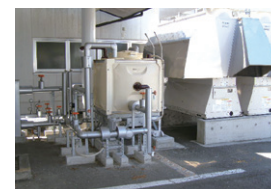
安装的蒸汽泵式电加热设备
