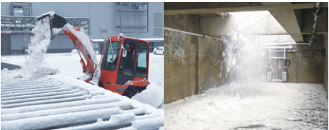
收集雪的地坑(左: 投入口、右: 地坑内)
