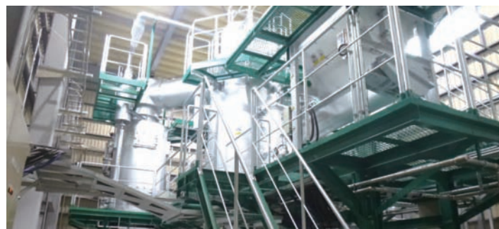
▲生物质锅炉(TDK-MCC股份有限公司 本庄工厂)
